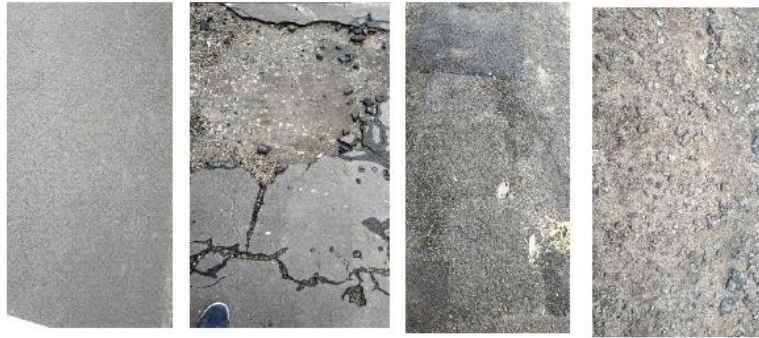
asfalt nový suchý asfalt rozbitý suchý smés povrchů mokrá štěk suchý
